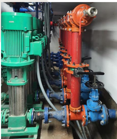
Centro de bombeo hotel Torre 90 - 2021
