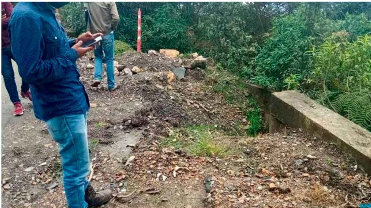
Figura 14. Inspección visual de una alcantarilla localizada en la vía Chiquinquirá-Otanche y registro de datos en campo por dispositivo móvil, incluyendo dimensiones de la sección transversal, estado de conservación, integridad de la estructura, procesos de erosión e inestabilidad del talud
