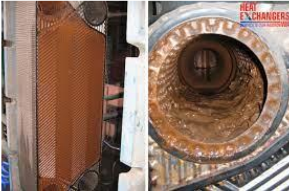
Coroziune în schimbatoarele de căldură
