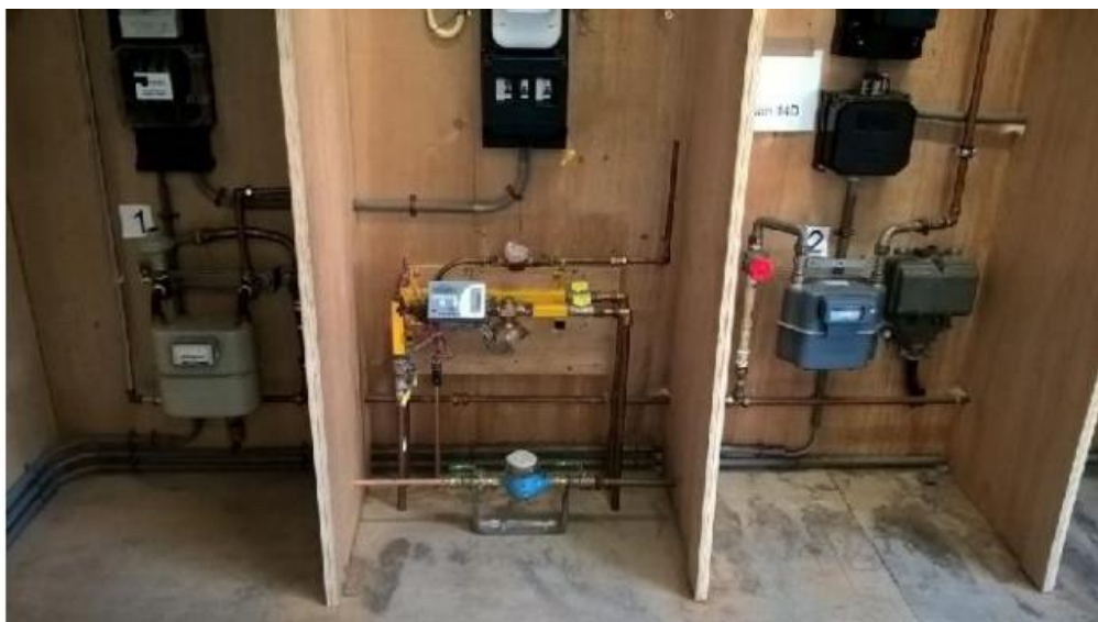
Figuur 2 In ons opleidingslokaal kunnen de monteurs oefenen met de praktijkopstelling
