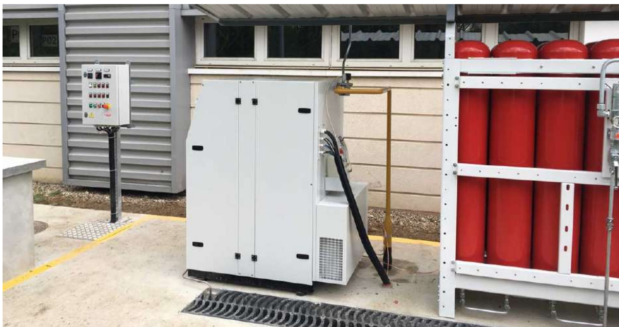
Unité de stockage © Gaz-mobilité
