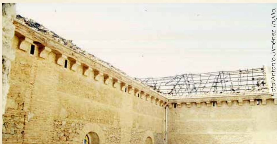
Imagen del exterior del templo con el techo destruido por el fuego.
