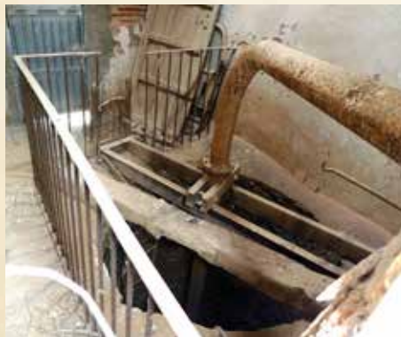
Estado actual de una de las casetas supervivientes que albergó uno de estos pozos.
