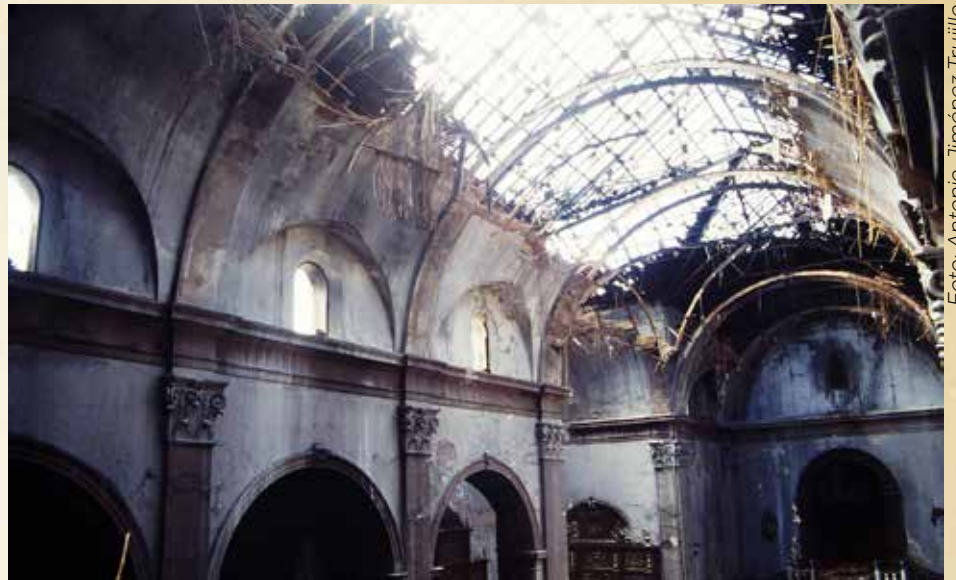
Estado del interior de la iglesia dos días después del incendio.
