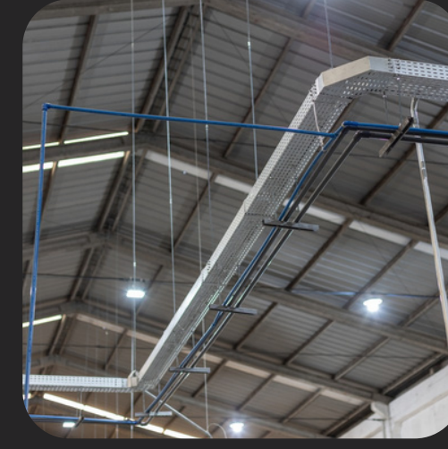
INSTALAÇÕES ELÉTRICAS INDUSTRIAL
