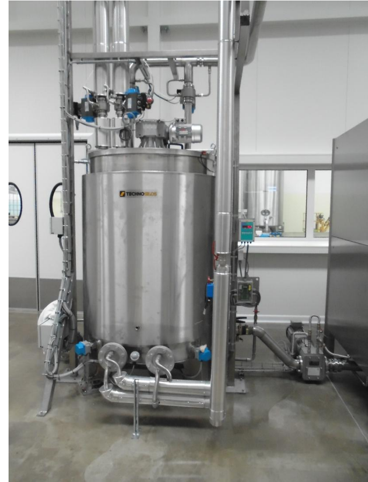
Tanques de preparación
