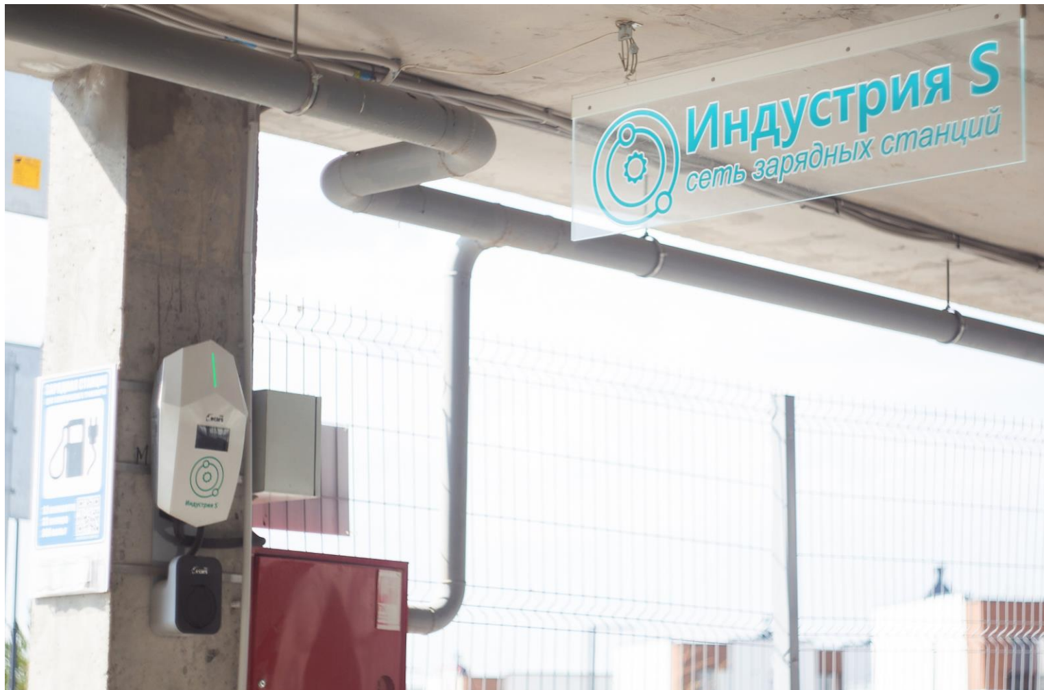
Демонстрационный терминал компании «ИНДУСТРИЯ-S». Паркинг. г. Тюмень, ул. Павла Шарова 40ст1
