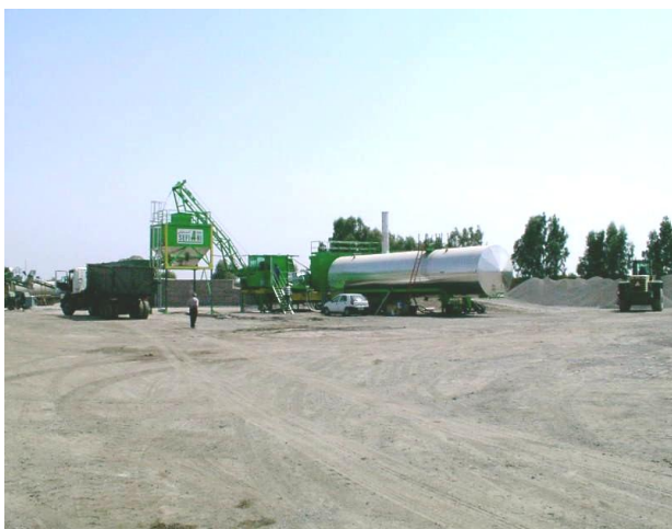
Vue d'une centrale d'enrobage
