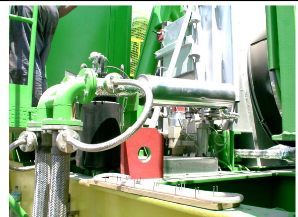
Vue de la pompe doseuse du bitume
