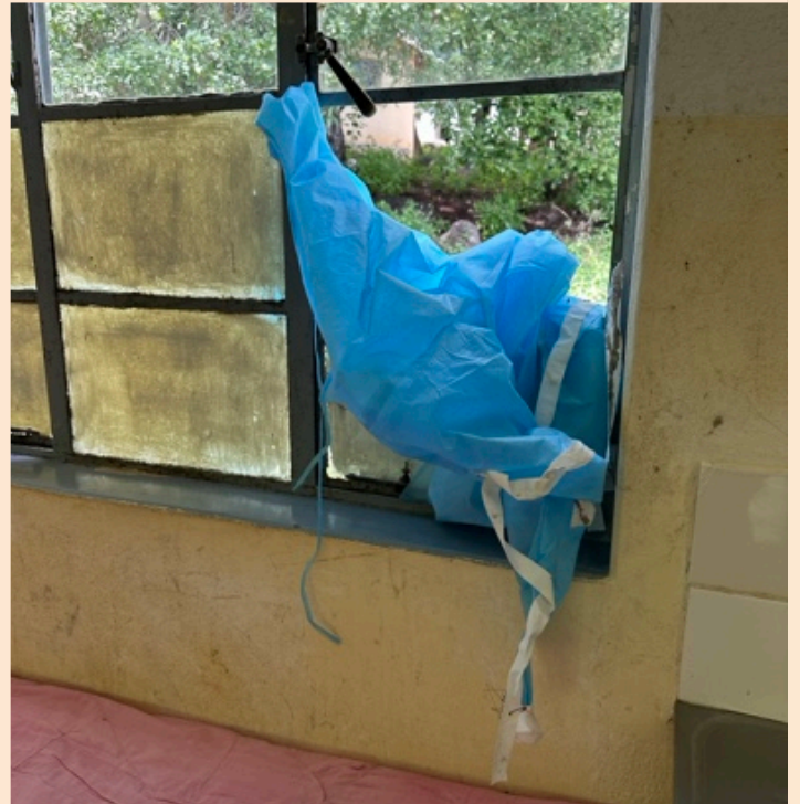
Provisorische Methode die defekten Fenster abzudichten.
