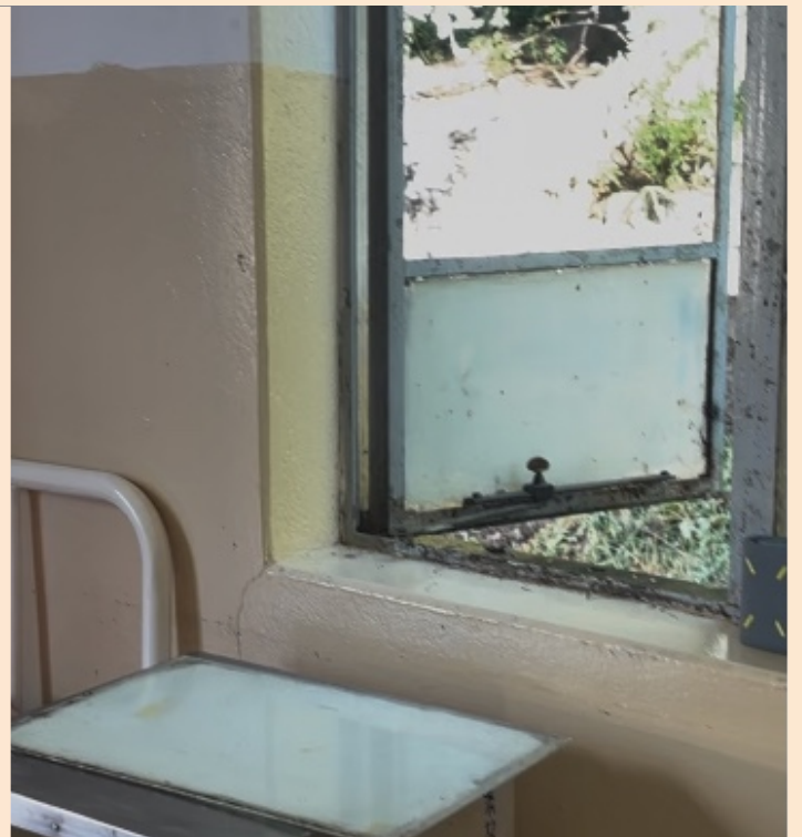
Nicht nur Regen und Kälte, sondern auch Insekten haben leichten Zugang durch die defekten Fenster.
