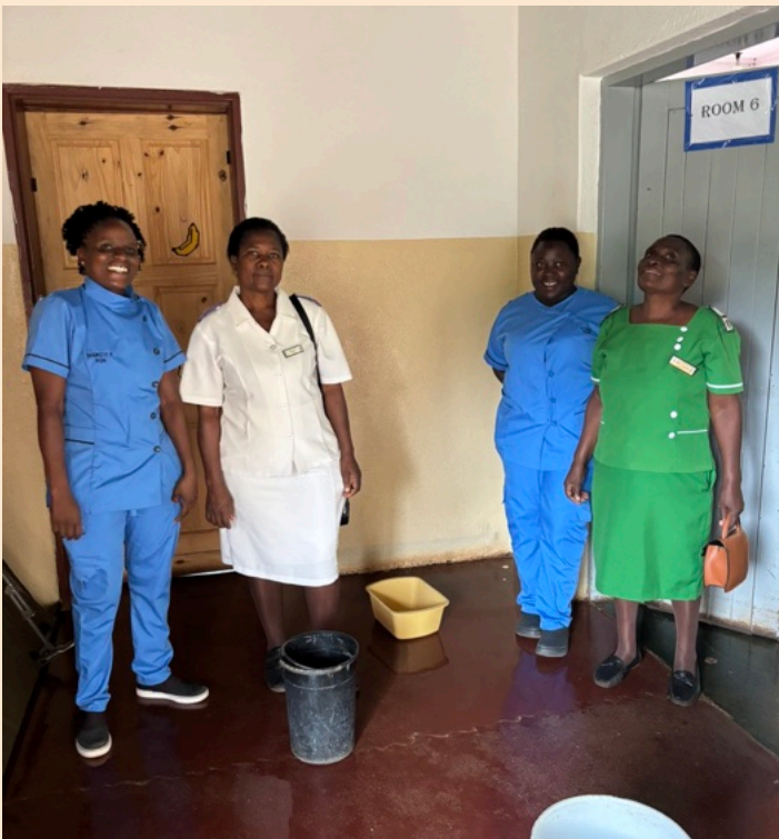
Wassereimer stehen unter den defekten Stellen im Dach.
