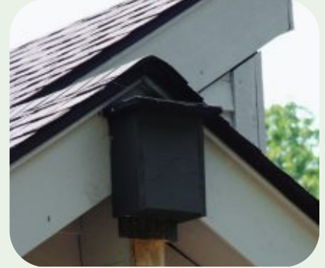
Dortoir à chauves-souris installé sur un toit
