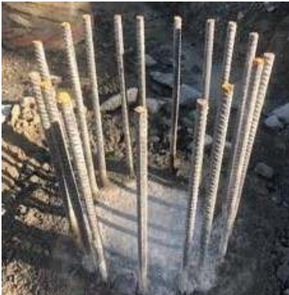
No Bent Rebars
