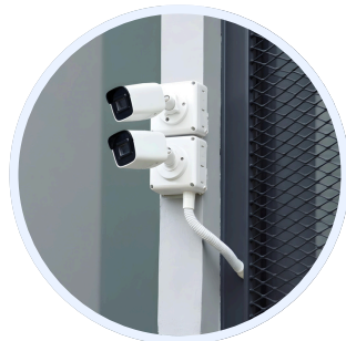
Pemasangan & Maintenance CCTV
