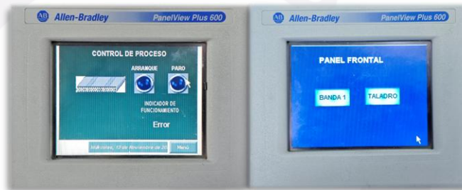
Programación HMI (Allen Bradley).
