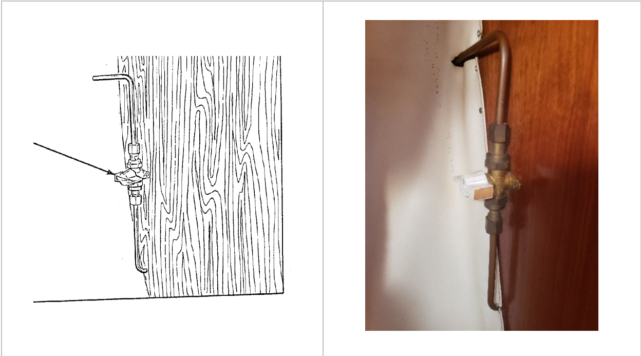
Vanne d'arrivée de gaz dans le placard de la cabine arrière bâbord
