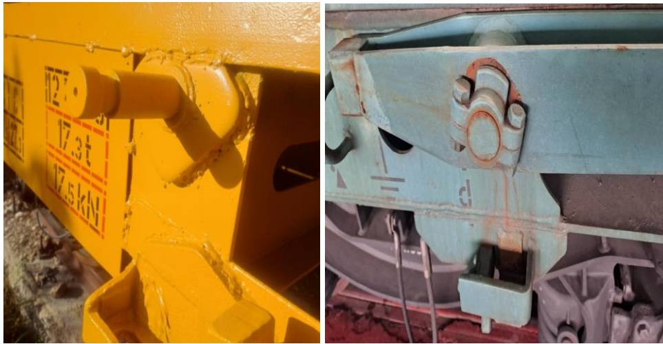
Şekil 16. Platform tipi vagonlarda dikme değişimi
