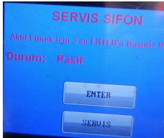
Şekil 117. Atık su tankı PLC servis sifon
