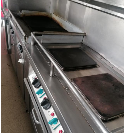
Şekil 139. Mutfak ızgara ve elektrikli ocaklar
