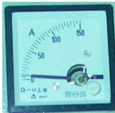
Şekil 33. DC yük akım göstergesi
