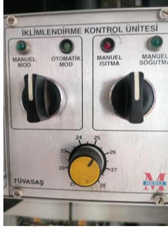
Şekil 55. İklimlendirme kontrol ünitesi
