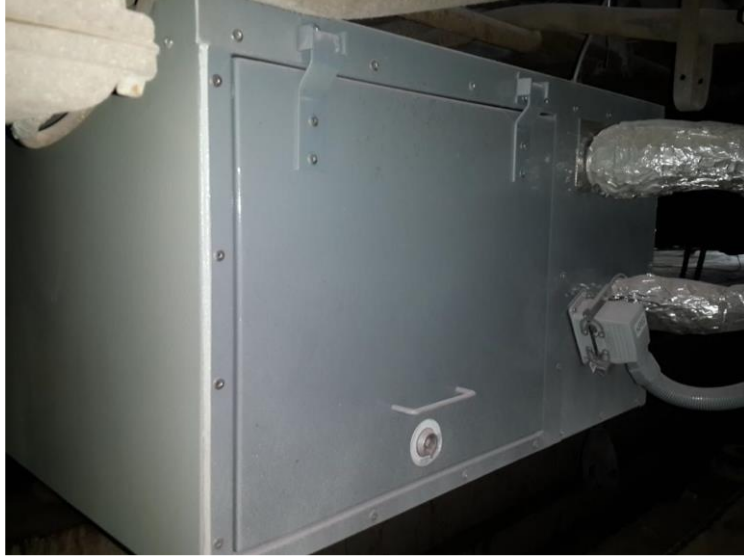
Şekil 127. Atık tankı bakım kapağı
