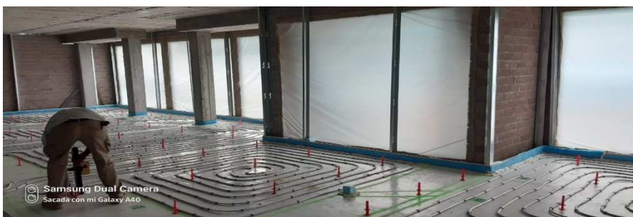
Tapado de ventanas con lámina plástica
