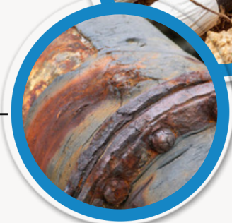
Korrosion an Wasserleitung
