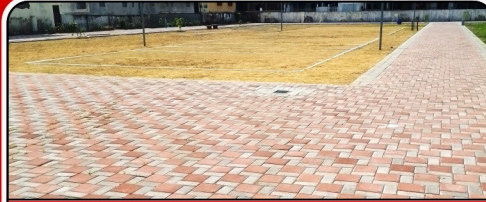
SMKN 3 Yogyakarta Cokrodingratan Jetis Yogyakarta Paving Kubus K300/8cm
