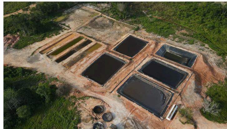
Planta de tratamiento propia
