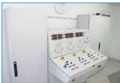
QUADRO ELETTRICO GENERALE
