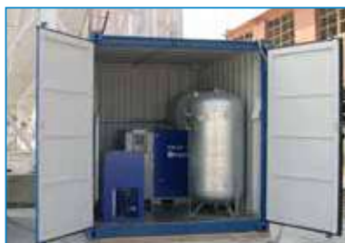
STAZIONE DI POMPAGGIO ARIA COMPRESSA
