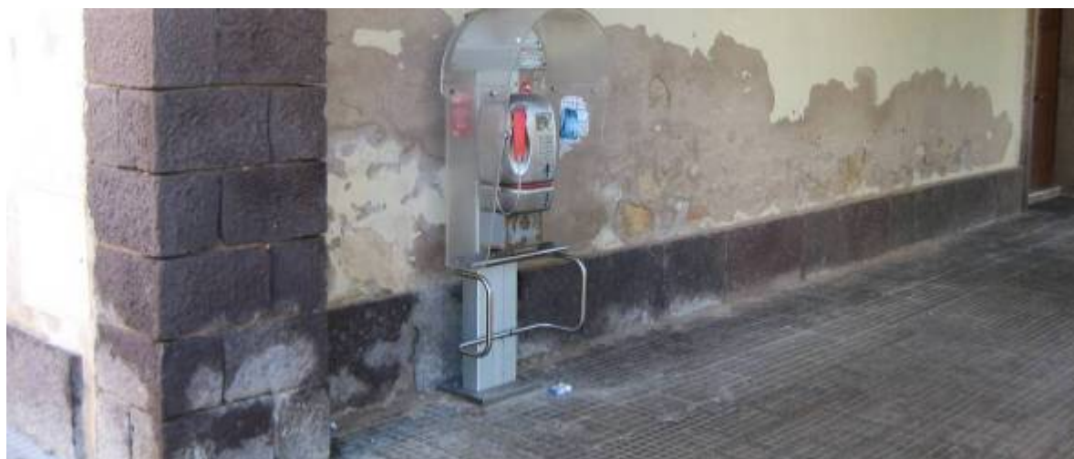
Fig. 72 – Edificio sud-est: distacco degli intonaci e degrado del paramento lapideo.
