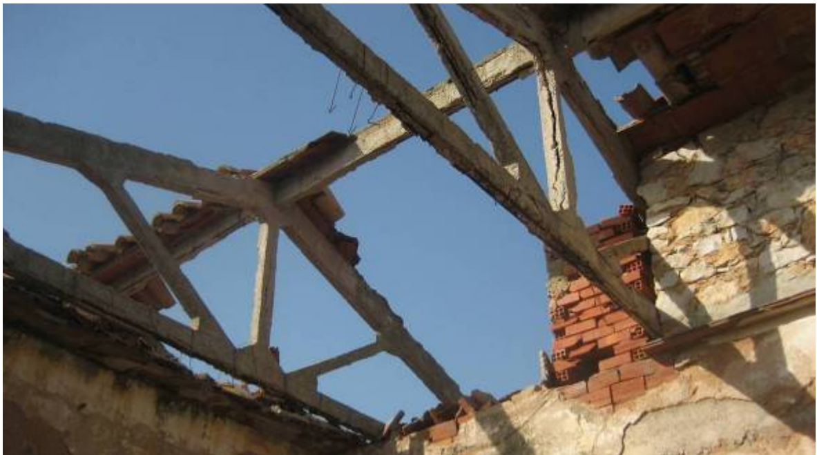
Fig. 79 – Interno del Palazzo Doria – piano primo: crollo del controsoffitto e del solaio di copertura a falde inclinate
