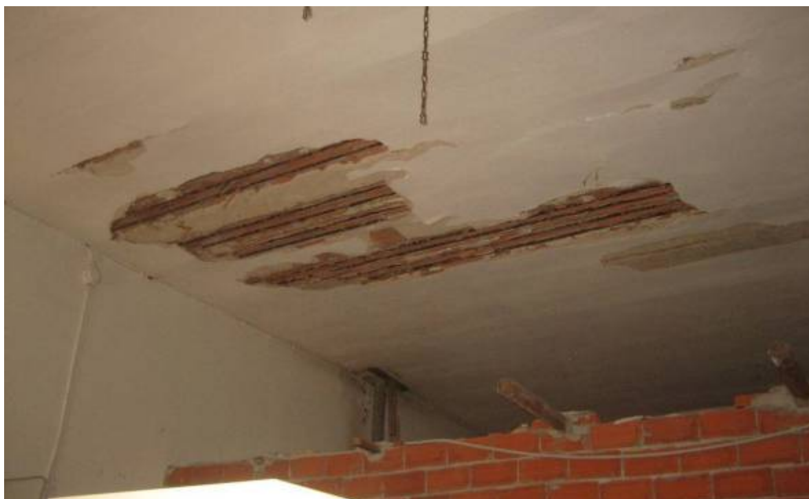
Fig. 36 – Ex Casa del Fascio - piano primo – vano nord: distacco di porzioni intradossali del solaio in latero-cemento.
