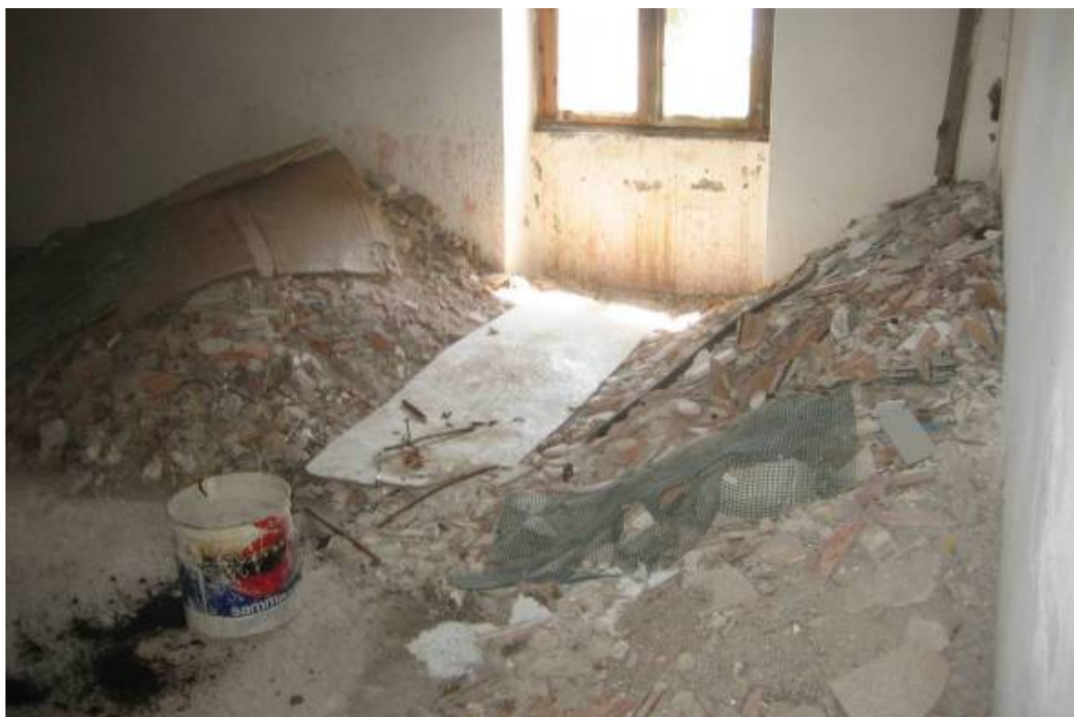
Fig. 38 – Ex Torre Littoria - piano primo: pericoloso accumulo non temporaneo di macerie, su solaio in parte già compromesso.
