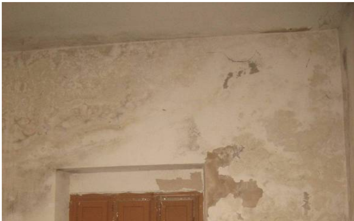
Fig. 37 – Ex Casa del Fascio -piano primo- interno della sede dell’A.N.V.G.D.: infiltrazioni dalla copertura piana, nel soffitto in latero-cemento e nelle pareti portanti perimetrali.
