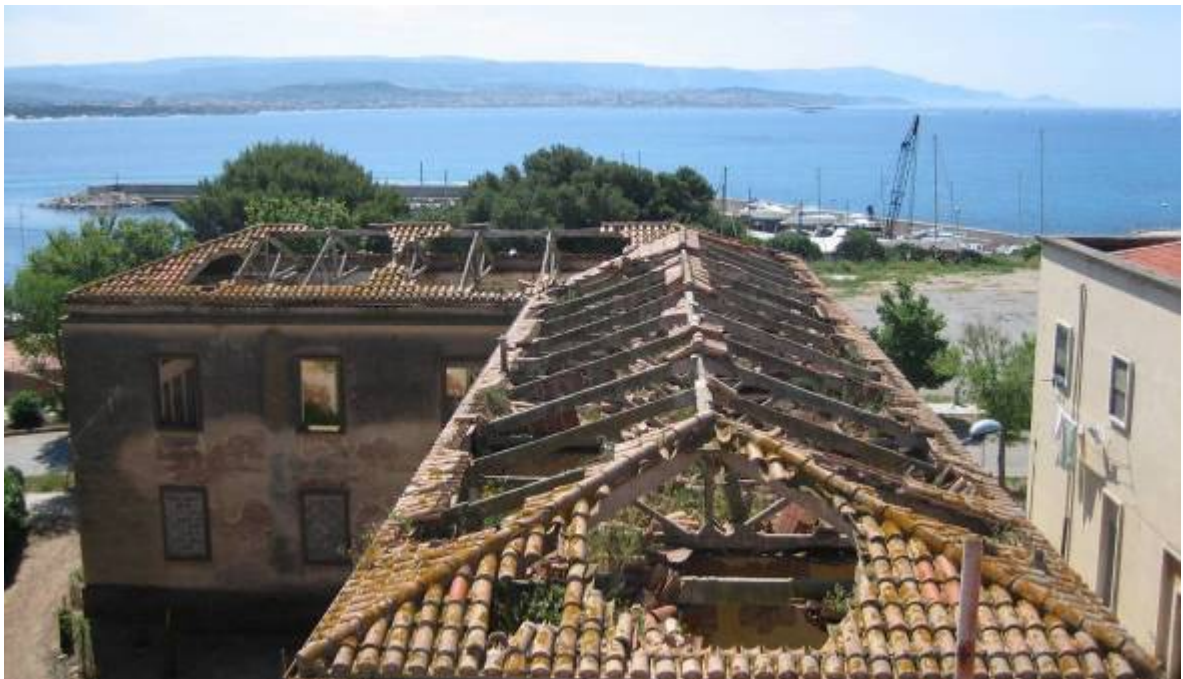
Fig. 80 – Interno del Palazzo Doria – piano primo: totale crollo delle coperture
