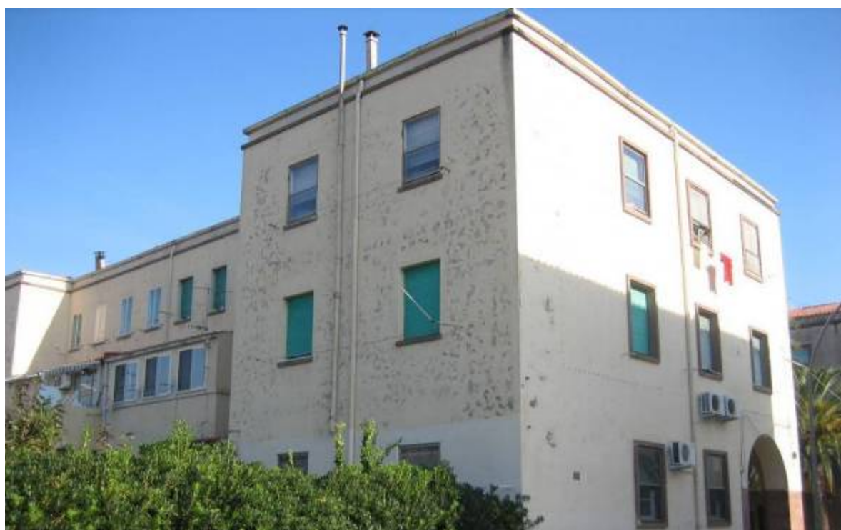
Fig. 73 – Edificio nord-ovest: distacco degli intonaci ed infiltrazioni nelle murature.
