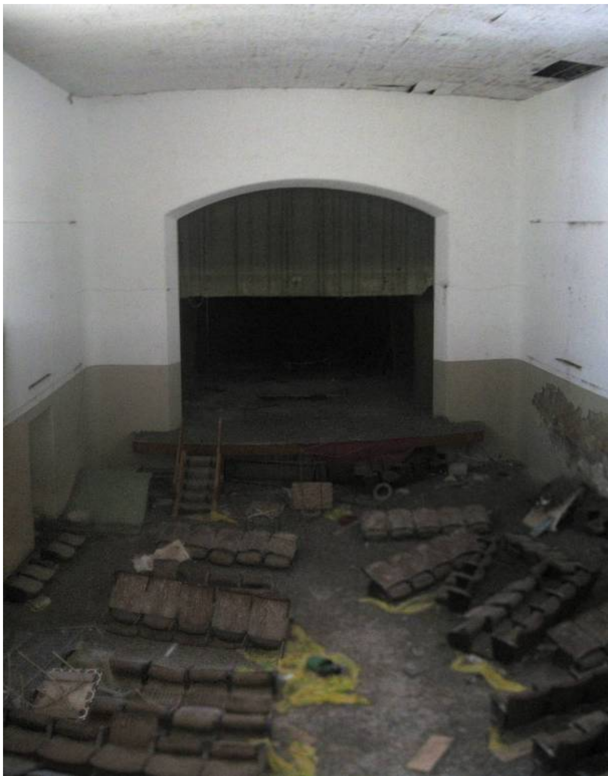
Fig. 28 – Interno dell'ex Cinema Teatro, ripreso dalla cabina di regia, con visibili gli effetti dell'incuria e degli atti vandalici. La massiccia presenza di guano di volatili, può solamente far immaginare la condizione di preoccupazione sociale, allarme e disagio collettivo dell'opinione pubblica, nel passato periodo dell'emergenza mondiale dovuto all'influenza aviaria.
