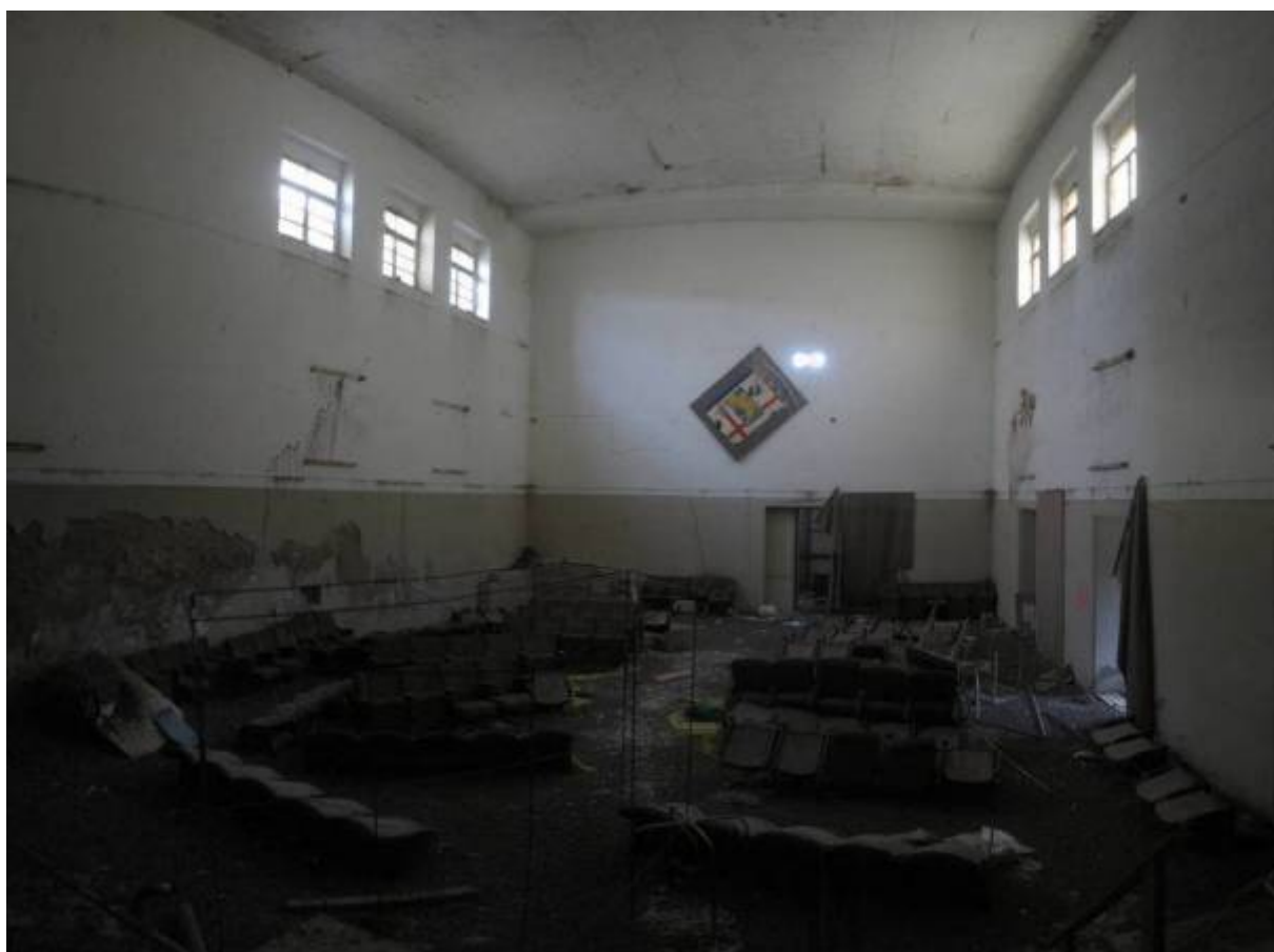
Fig. 27 – Interno dell'ex Cinema Teatro, ripreso dal palco a nord, con visibili gli effetti dell'incuria e degli atti vandalici.
