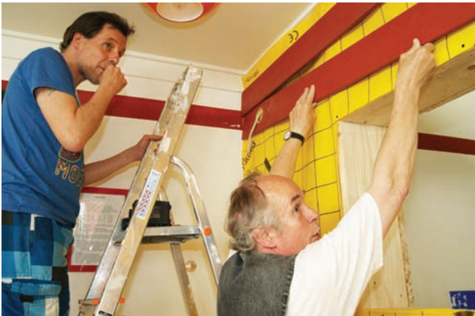
Zimmermann Ingo Lübben bringt eine Latte in Position, damit Daniel Satzky mit dem Akuschrauber loslegen kann.
