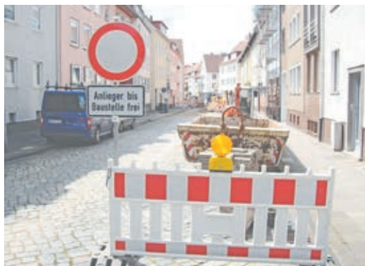
Eingeschränkte Befahrbarkeit der Straße
