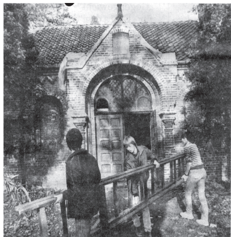
Jüdische Kapelle wurde durch die Arbeitsgemeinschaft „Beth Shalom“ von Herrn Hahn vor dem Verfall gerettet.
