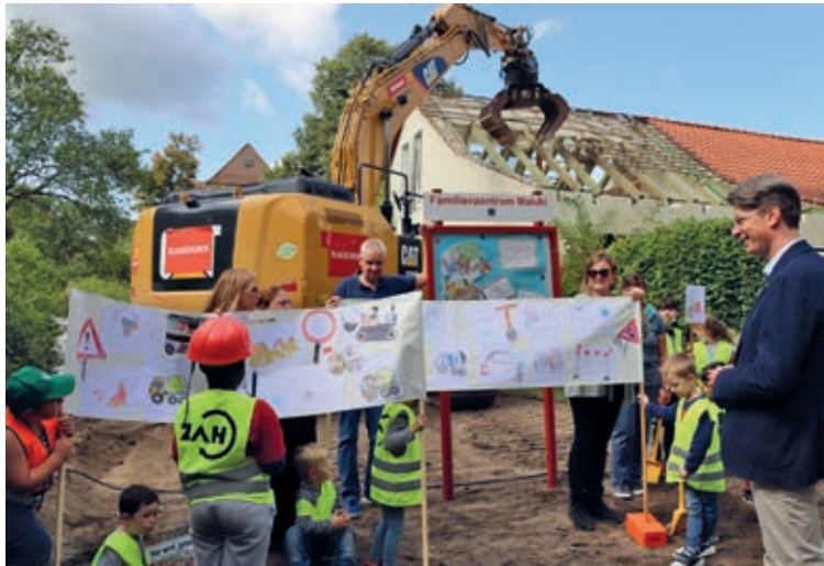
Kinder des Maluki hatten extra zum Beginn des Umbaus Banner angefertigt, die sie Oberbürgermeister Dr. Ingo Meyer (r.) erläuterten.
