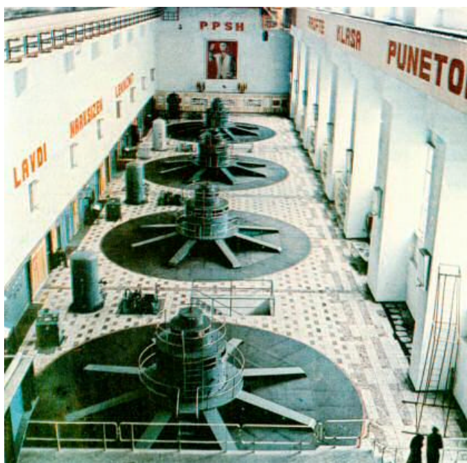
Vue de la salle des turbines de la centrale hydro-électrique «La Lumière du Parti» de Fierze
