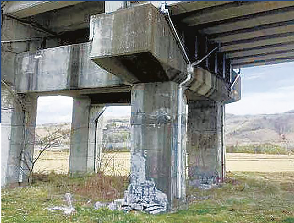
（鉄骨の錆による破裂・錆汁、セメントアルカリによる塗装の加水分解、多量の白華など）
