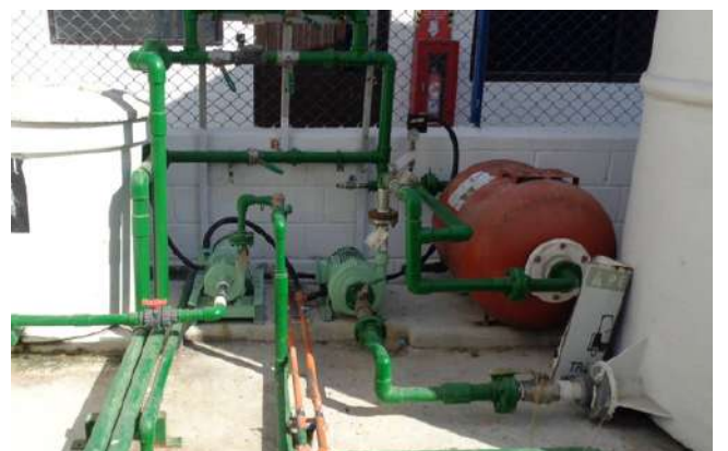
Adecuaciones de planta de Osmosis inversa. Cliente: Nalco Champion.
