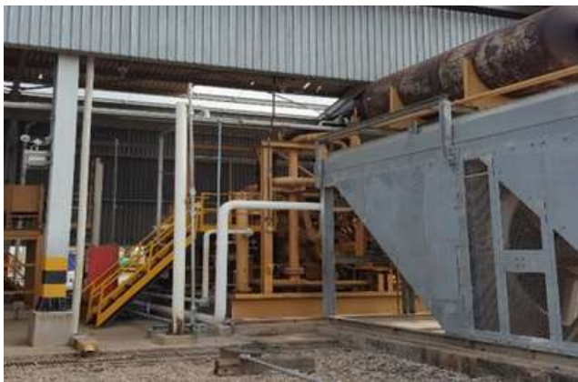
Administración, Operación y Mantenimiento Estación de Compresión Filadelfia. Capacidad: 70 MMSCFD.
