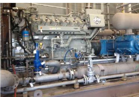
Suministro e instalación de dos (2) unidades de compresión Waukesha - Ariel para Campo El Difícil. Cliente: PETROSUD.
