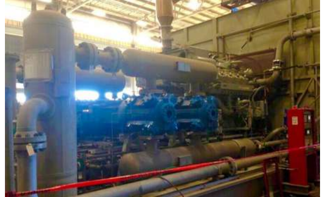
Sistema de compresión de gas, Cliente: Petroleos Sudamericanos Energy -2018.
