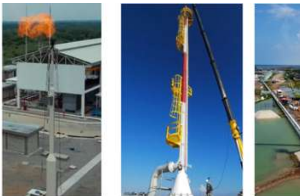
Suministro de TEA para estación compresora y Mantenimiento TEA Clientes: Gases del caribe - Hocol
