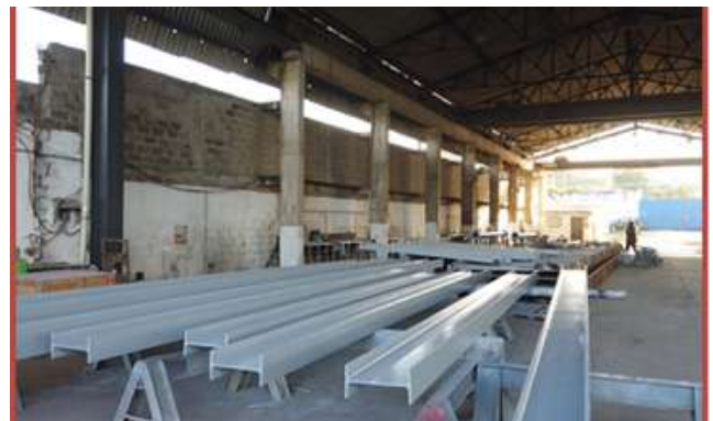
Prefabricación de spools y soportes en estructuras metálicas según esquemas de Reficar. Cliente: Termotécnica
