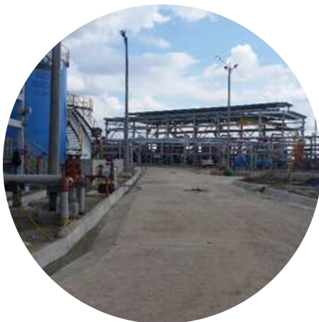
Administración, Operación y Mantenimiento CPF Bonga-Mamey. Capacidad: 30 - 60 MMSCFD.
