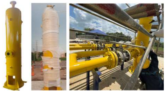
Suministro de Scrubber Cliente: Termocaribe - 2023
