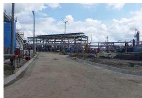
Obras de Terminación del CPF Bonga-Mamey para el tratamiento y compresión de 60 MMSCFD de gas natural, para la empresa PROMISOL..
