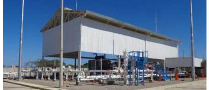
Administración, Operación y Mantenimiento Estación de Compresión La Paz. Capacidad: 20 MMSCFD.
