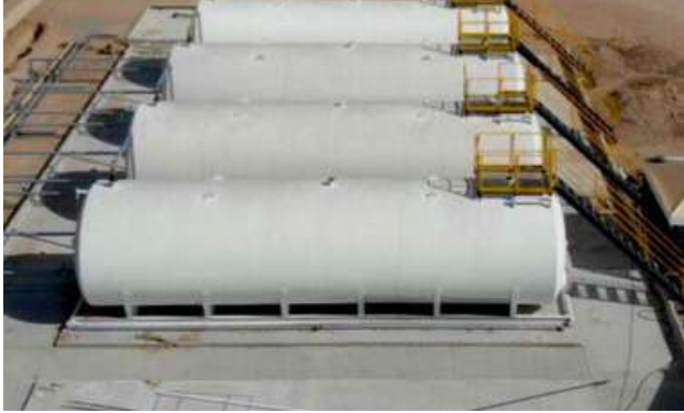
Tanque de almacenamiento CPF Maria conchita Cliente: Quadranti - 2021
