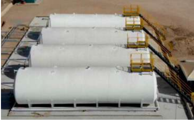
Tanque de almacenamiento CPF Maria conchita. Cliente: Quadranti.
