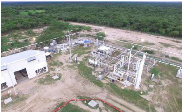
Diseño e instalación de planta MRU para tratamiento de 30 MMSCFD. Cliente: Quadranti
