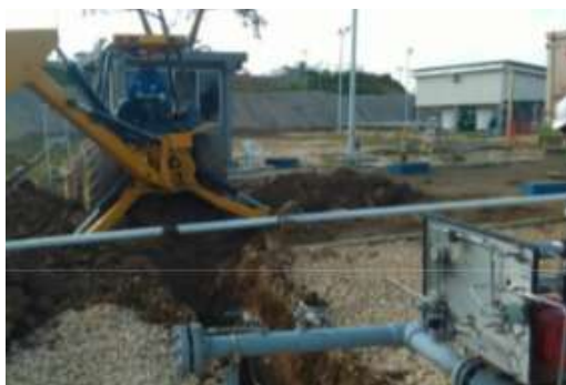
Diseño y Construcción de Cruce de Gasoducto. Cliente: SURTIGAS. Estación de Bombeo La Granjita, OCENSA.
