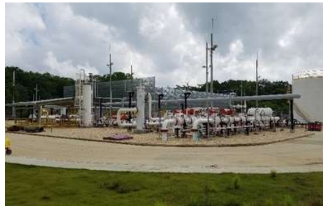
Administración, Operación y Mantenimiento Estación de Compresión Sahagún. Capacidad: 90 MMSCFD.
