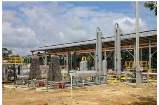
Administración, Operación y Mantenimiento Estación de Compresión Jobo. Capacidad: 60-100 MMSCFD.
