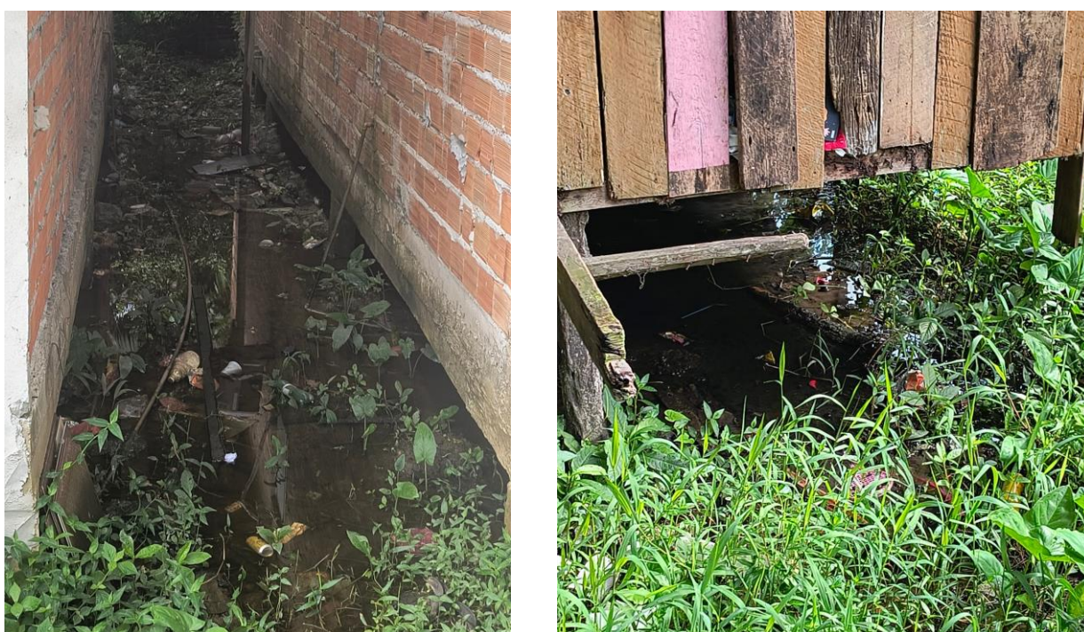
Figura 5 - Esgoto Sanitário despejado inadequadamente no Porto Ceasa. Fonte: Autores.
