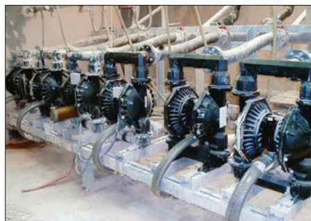
Bombas de diafragma de 3" (76,2 mm) instaladas sobre una plataforma para transferir arcilla para la fabricación de cerámica
