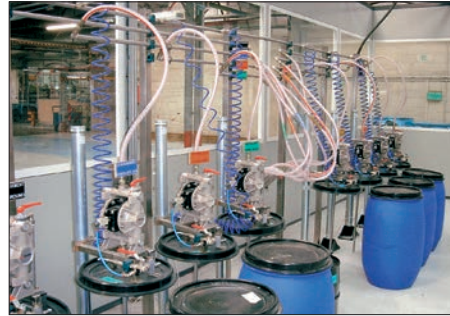
Bombas de diafragma de 1/2" (12,7 mm) instaladas en un sistema de coloración
