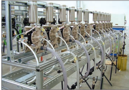
Bombas de diafragma de 1/2" (12,7 mm) instaladas en un sistema de formulación de tintas
