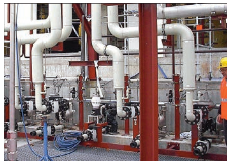
Bombas de diafragma de acero inoxidable de 2" (50,8 mm) con amortiguadores de pulsaciones de PVDF que se utilizan para descargar ácido fluorhídrico
