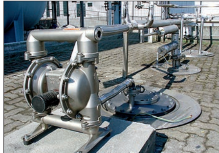
Bomba de diafragma de 1 1/2" (38,1 mm) instalada en un proceso químico para transferir cloruro de metileno
