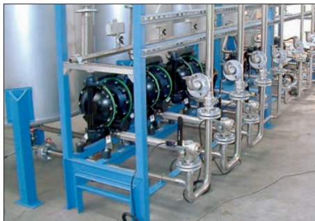
Bombas de diafragma de aluminio de 1 1/2" (38,1 mm) instaladas para alimentar un reactor químico
