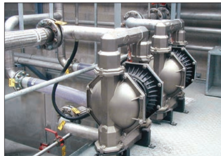
Bombas de diafragma de acero inoxidable de 3" (76,2 mm) instaladas en un proceso de transferencia a granel
