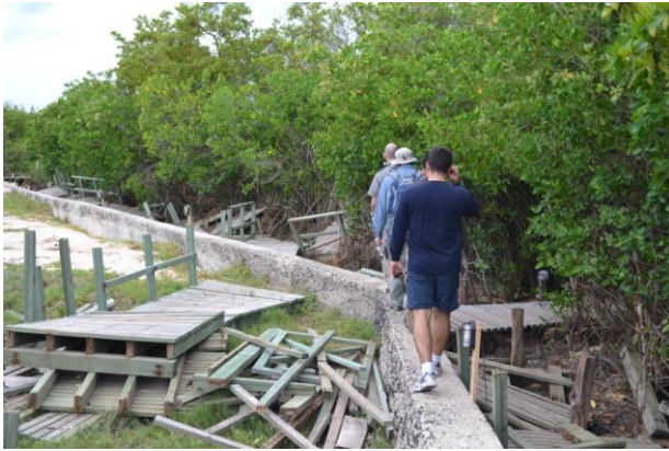
Figura 25 Daños producidos por el impacto de las olas, en la ruta a Punta Estrada.
