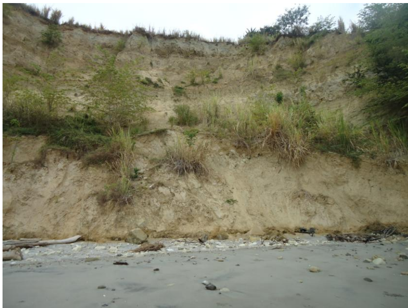
Foto 23.- Deslizamiento de la parte superior del acantilado
