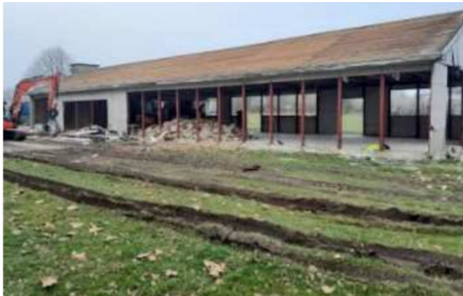
Bâtiment à démolir où on peut voir l'absence de sécurité
