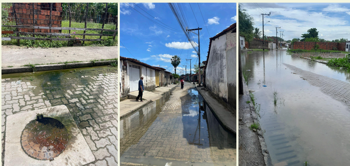
Figuras 10, 11 e 12. Imagens de Pontos de Alagamentos após obras do PROINFRA.
