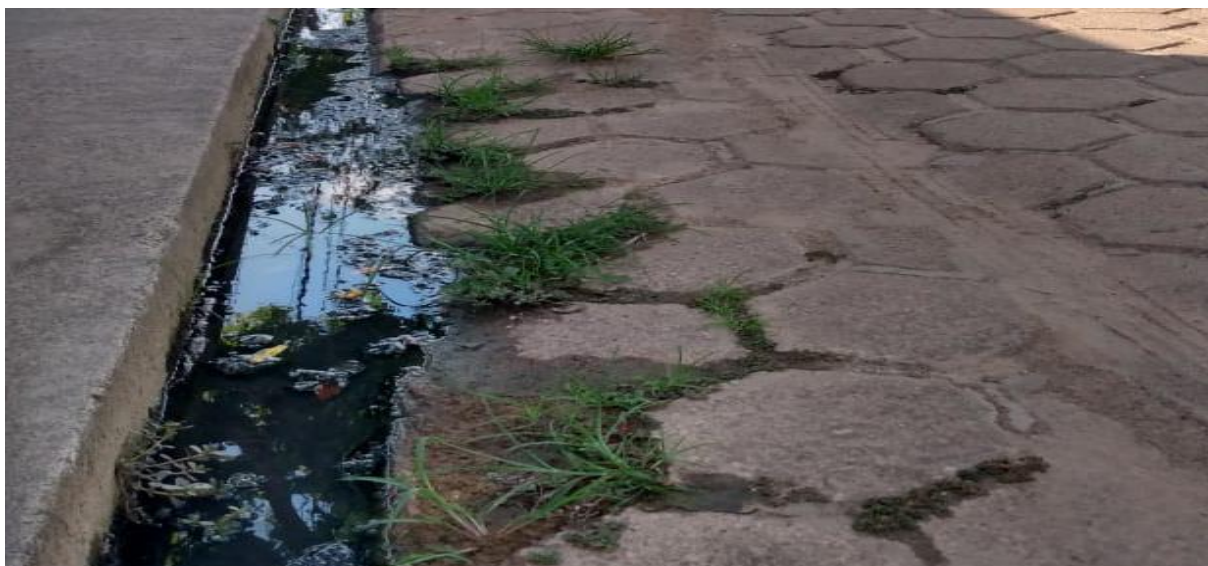
Figura 3: Rua pavimentada com esgoto ao ar livre na cidade de Cametá
