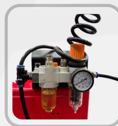
Filtro regulador e lubrificador instalado.
