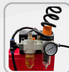
Filtro regulador e lubrificador instalado.
