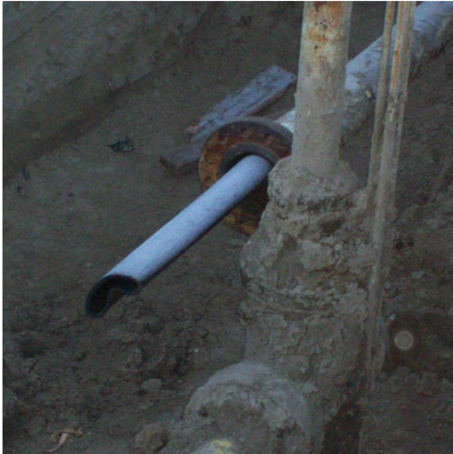
Figura 4: Extracción de una sección de 'liner' colapsado en servicio
