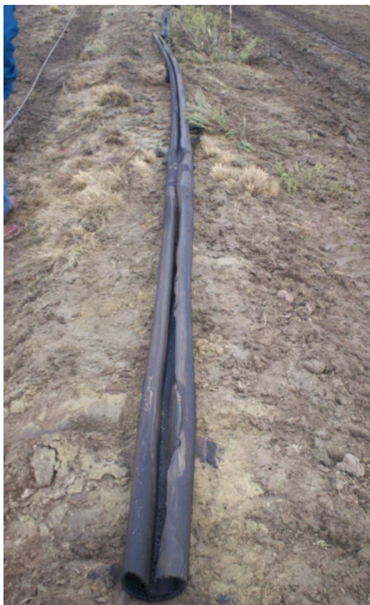
(a) Sección de 'liner' colapsada.
