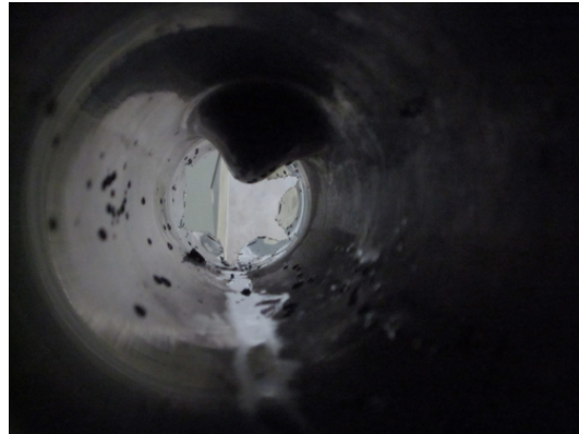
(b) Vista interior del 'liner' colapsado.
