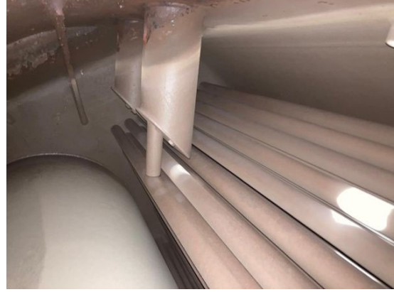
Görsel 2 – Kazan boru hatları genel görünüm
