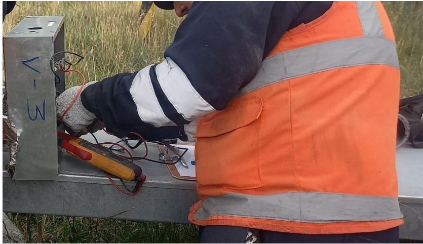
Se verifico conexiones eléctricas de las resistencias
