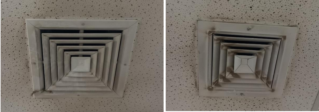
Estado inicial de difusores del sistema de climatización con acumulación de polvo
