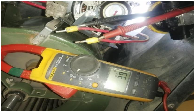
Se realizó pruebas de estado del bobinado de los motores eléctricos
