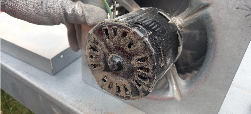
Equipo extractor con acumulación de polvo en parte del motor eléctrico
