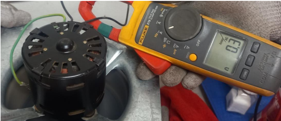
Se realizó pruebas de funcionamiento después del mantenimiento
