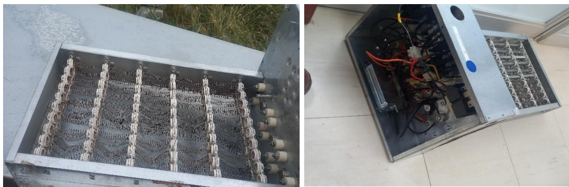
Se hayo fallas en el banco de resistencias de los equipos de ventilación
