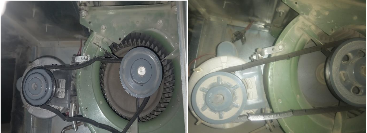
Se registraron fallas en el sistema de transmisión por desgaste en los ventiladores
