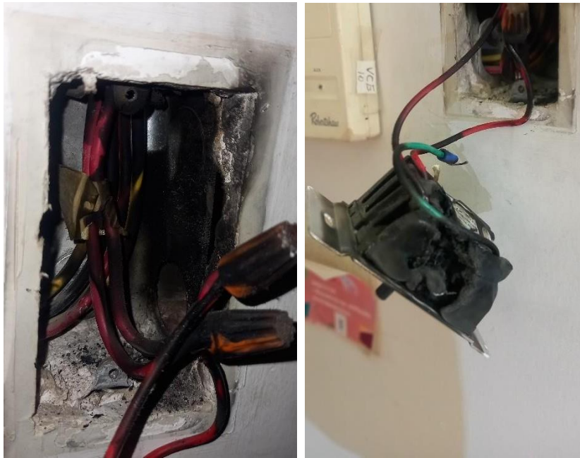
Se registraron fallas en el sistema de variador de velocidad del sistema de ventilación
