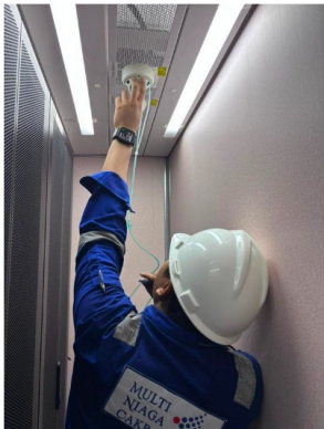
Pengecekan Detector FSS
