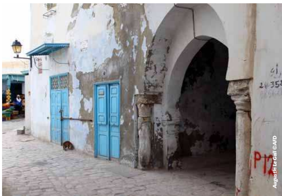
Quartier ancien dégradé de la ville formelle Médina de Kairouan (Tunisie)
