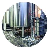
Réservoir à eau
